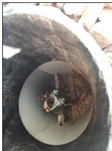
Figura 10 – Caixas de passagem / inspeção.
