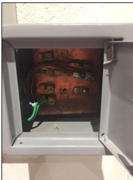
Figura 12 – Caixa de equipotencialização.
